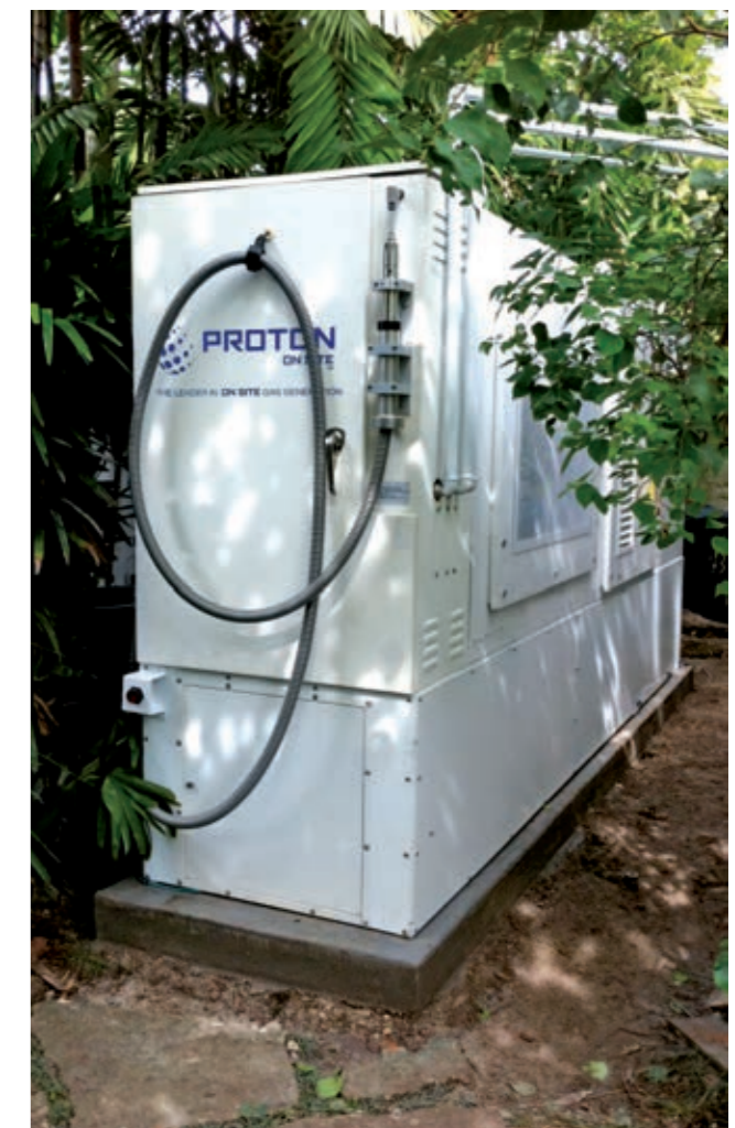
Abbildung 16: Prototyp einer dezentralen Wasserstoff-Tankstelle „Home refueller“, Aufstellung an einem Privathaus (Quelle: Proton Onsite)
