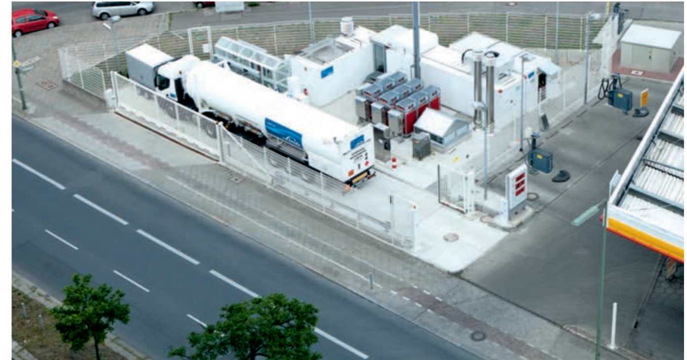
Abbildung 23: LH 2 -Anlieferung an der Shell-Tankstelle in Berlin Sachsensdamm (Quelle: Linde)
