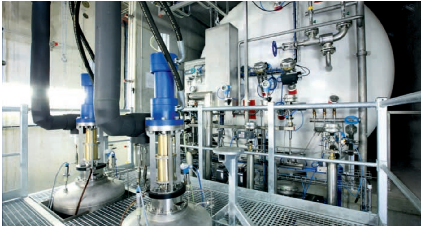
Abbildung 22: Zwei LH 2 -Pumpen und ein LH 2 -Speicher (Hintergrund) an der Shell-Tankstelle Berlin (Quelle: Linde)
