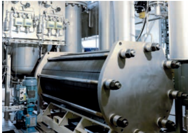
Abbildung 20: Alkalischer Elektrolyseur der Firma NEL Hydrogen (früher Statoil Hydrogen Technologies) an der Wasserstoff-Tankstelle in der Holzmarktstraße, Berlin (Quelle: NEL Hydrogen)
